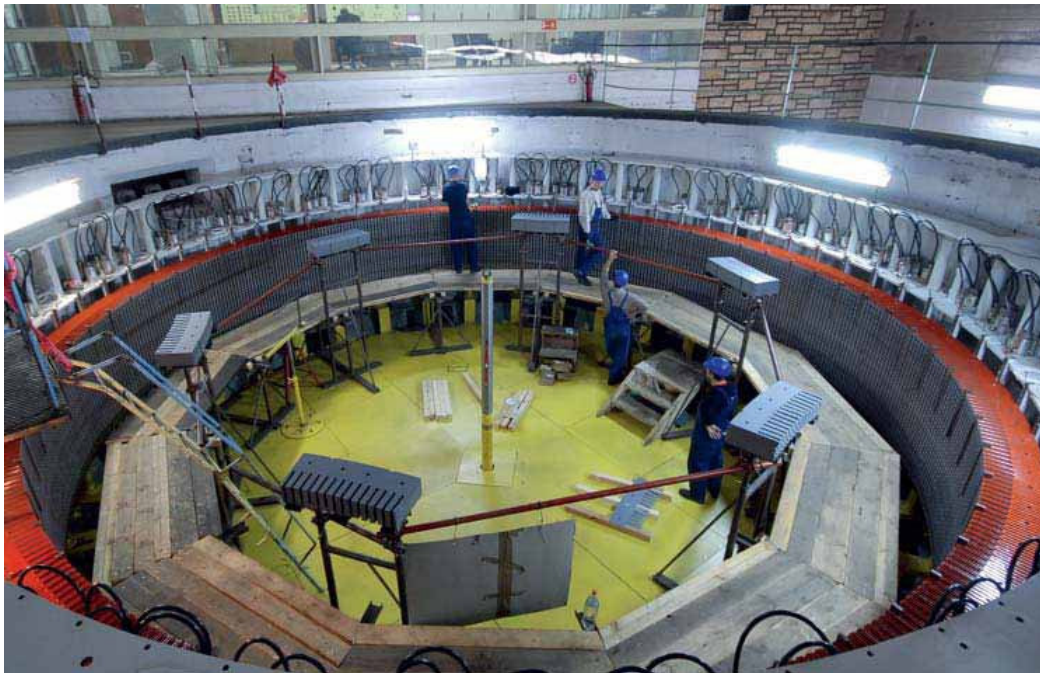
Slika 1.3. Slaganje limova magnetnog kola statora hidrogeneratora. Magnetno kolo većih mašina izrađuje se od segmenata. Stator u HE Bajina Bašta.
