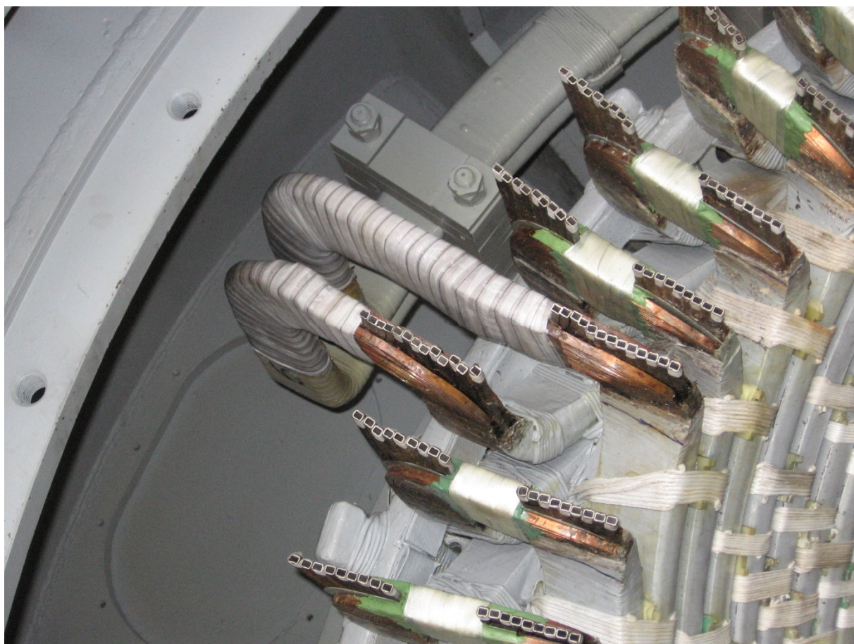
Slika 1.7. Glava namotaja statora sa izvodima kanala za hlađenje namotaja vodom.
