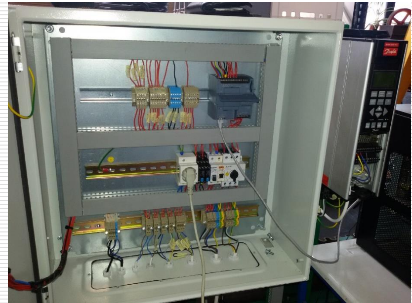
Slika. Orman lica mesta sa frekventnim pretvaračem postavljenim sa desne strane
