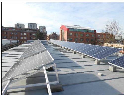
Slika 2.1. FN elektrana snage 16,3 kW na krovu mašinskih instituta FTNa.
