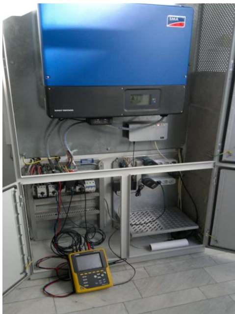
Slika 102: Izgled RO FN elektrane FTN1
