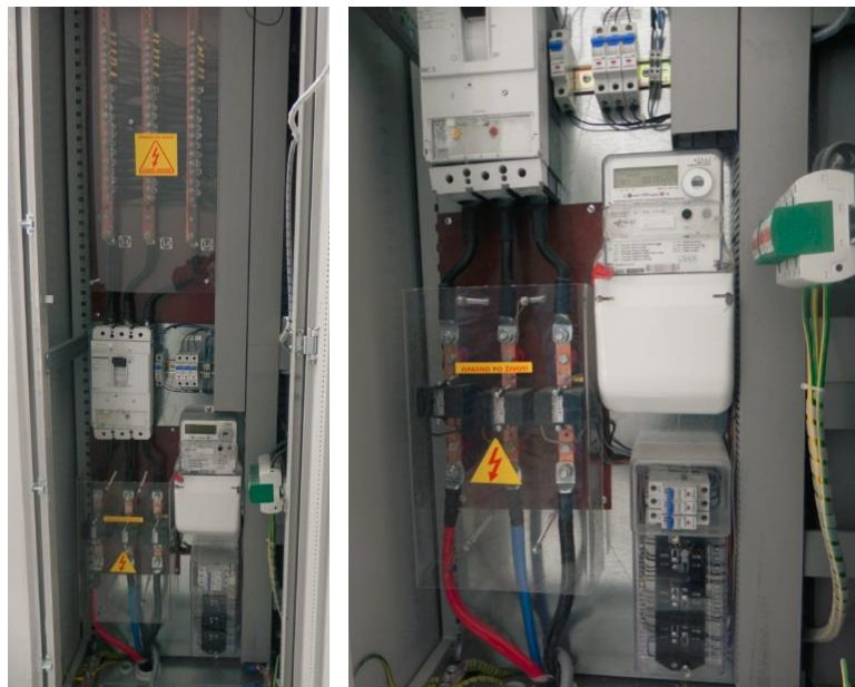
Slika 108: Razvodni ormar Kule (levo) i mesto priključenja AKVEE (desno)
