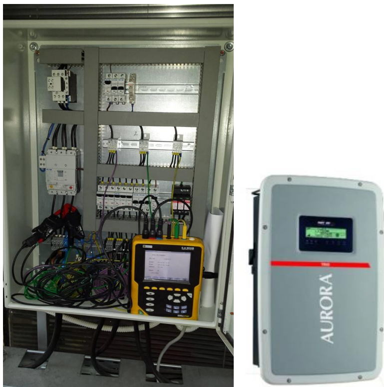
Slika 103: Razvodni ormar FN elektrane FTN2 i string inverter
