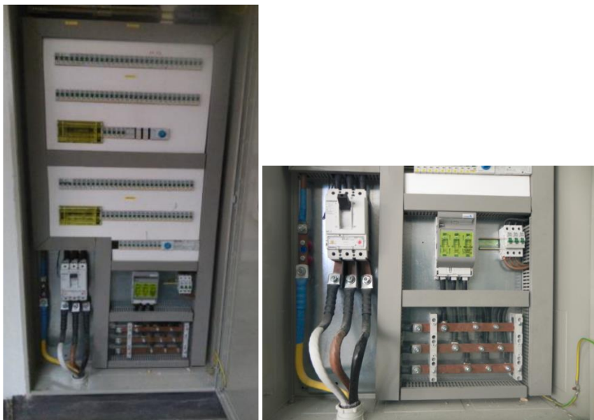
Slika 109: Razvodni ormar amfiteatara A1 i A2 (levo) i mesto priključenja AKVEE (desno)
