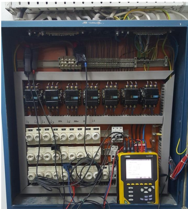
Slika 105: Razvodni ormar u računarskom centru sa priključenim AKVEE
