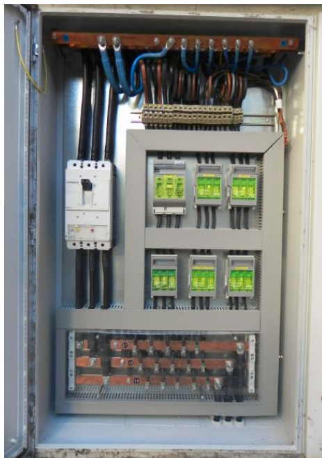
Slika 110: Izgled glavnog razvodnog ormara bloka F
