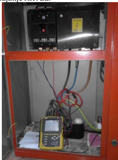
Slika 112: Detalj glavnog razvodnog ormara ITC sa priključenim AKVEE
