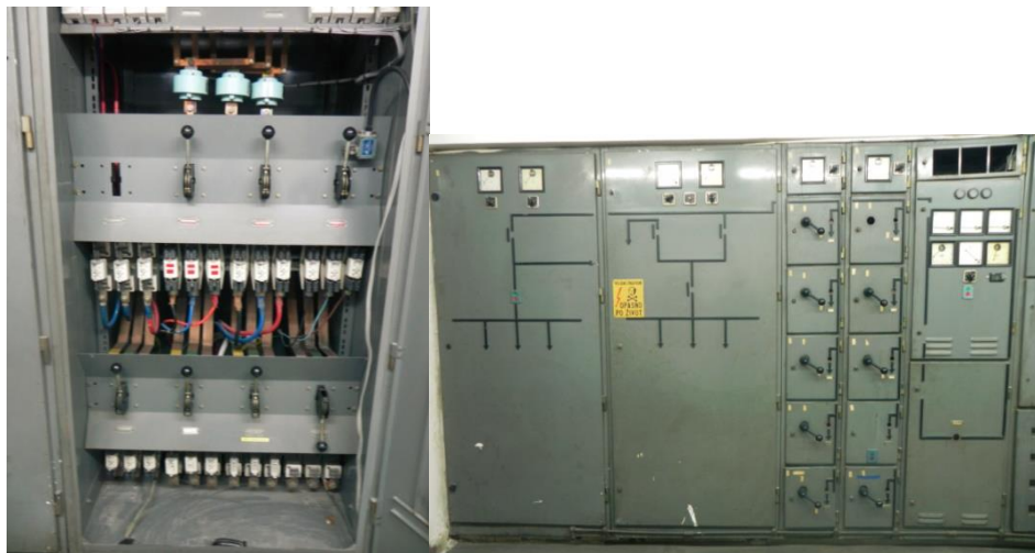
Slika 111: Niskonaponski razvod u TS Mašinskog instituta (levo) i izgled bloka gde se priključuje AKVEE (desno)
