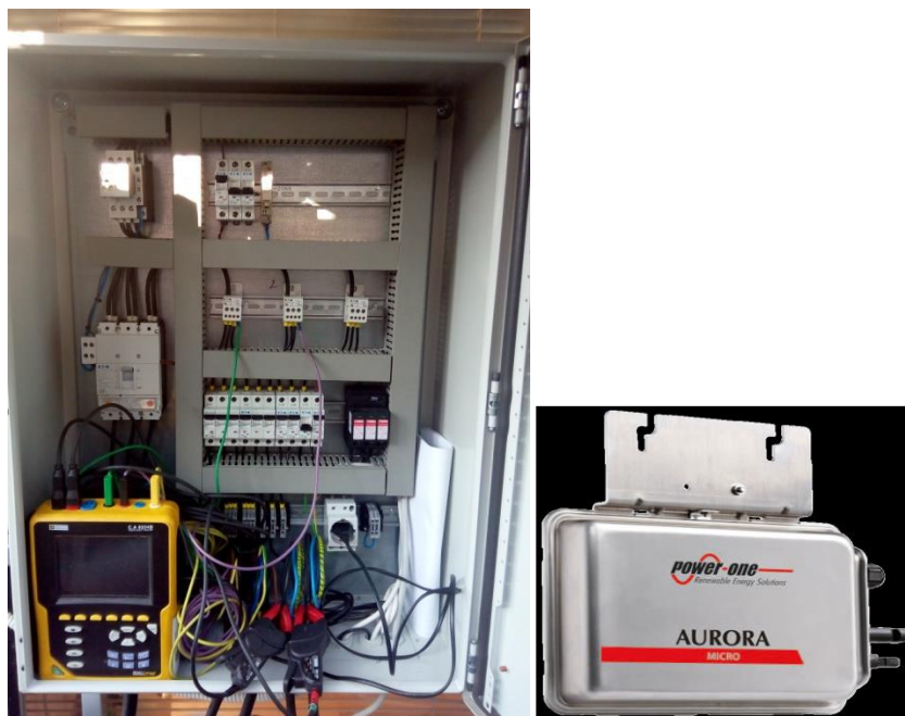
Slika 2: Razvodni ormar FN elektrane FTN2 i mikroinverter
